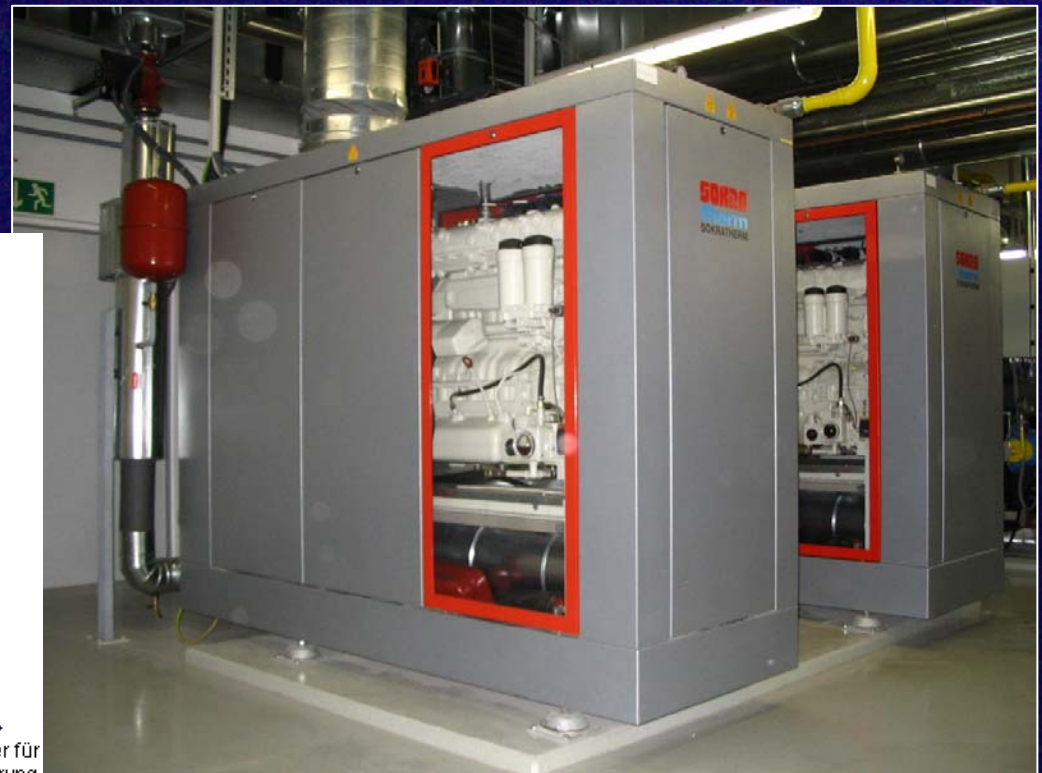
Beispiel Evgl. Christophoruswerk Duisburg, 2-moduliges BHKW
