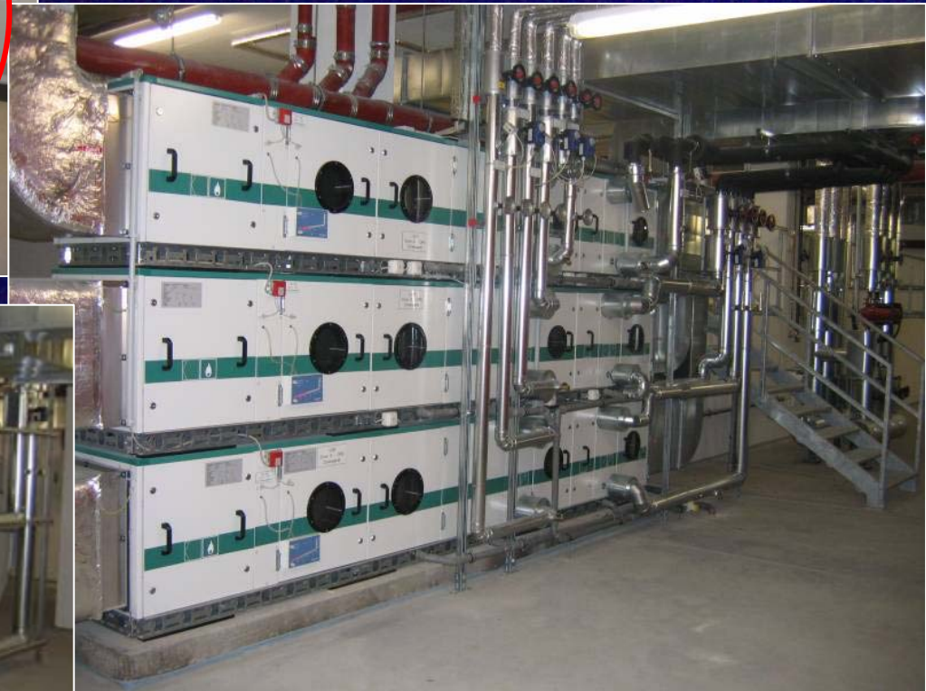
übereinander angeordnete Nachbehandlungsgeräte
